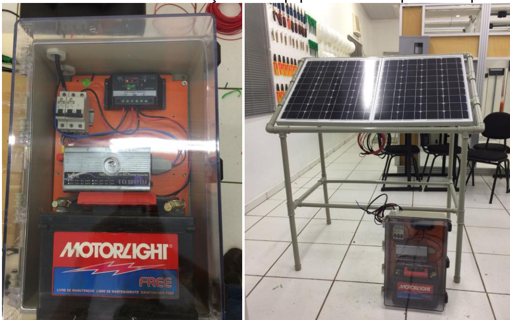
Figura 13. Suporte das placas solares e painel elétrico. Foto: GUIMARAES, Allan, 2017
